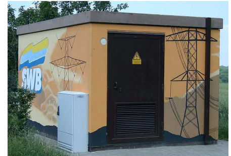
Centro de transformación
