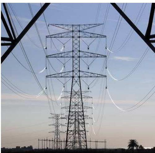
Líneas de alta tensión
