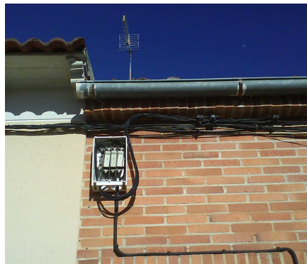
Acometida aérea en fachada y CGP
