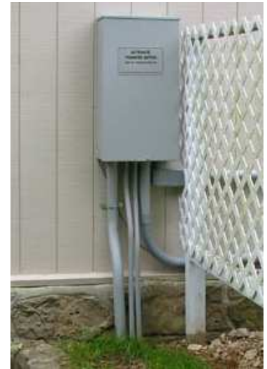
Detalle de la línea de acometida y la Caja General de Protección.
