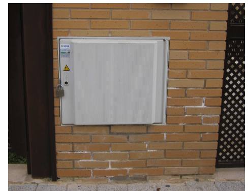
CGP en fachada de un edificio
