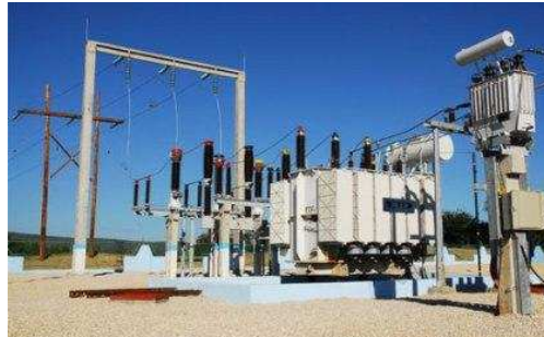
Estación de transformación
